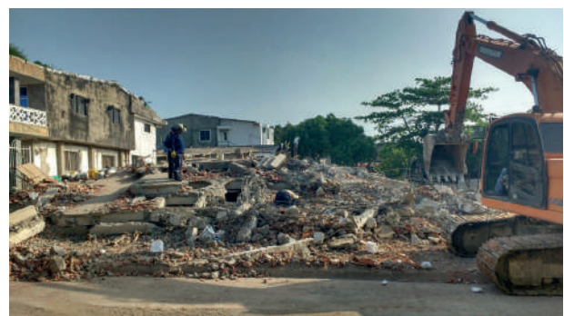
Escombros tras la caída del Blas de Lezo II
